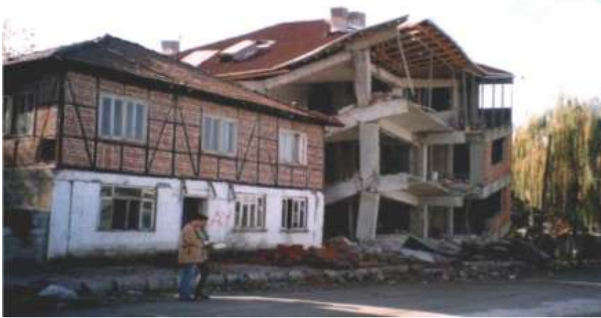
Şekil 6: 1999 depreminde Kaynaşlı’da ahşap hıms ve betonarme iki evin durumu (URL-6).
