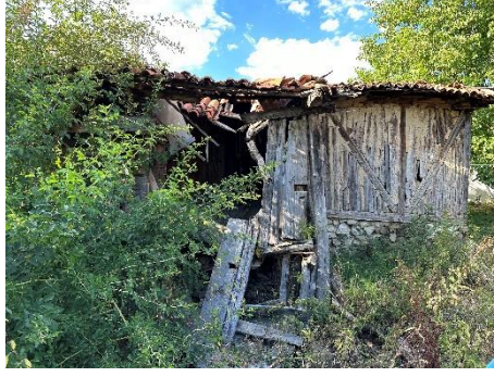
Şekil 7. Çatısı ve taşıyıcı sistemi zarar gören konut örneği
