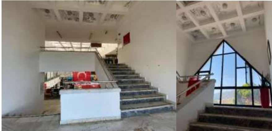
Yapıdaki Hasarlar (İsmailoğlu, 2022)
