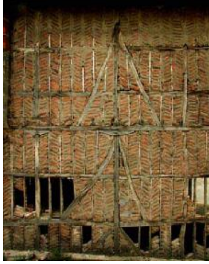
Şekil 11. Hımsış sistemiyle inşa edilmiş yapıda deprem hasarı örneği (Korkmaz, 2007: 63).
