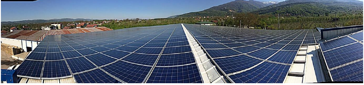
Şekil 2. 290,4 kWp çatı tipi şebekeye bağlı FV sistem
