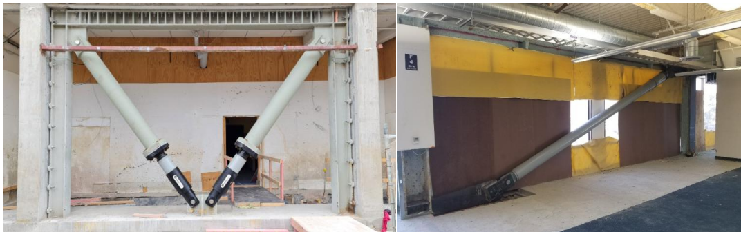
Şekil 3. Viskoz Akışkanlı Sönümleyici Güçlendirme Uygulamaları (Taylor Devices)
