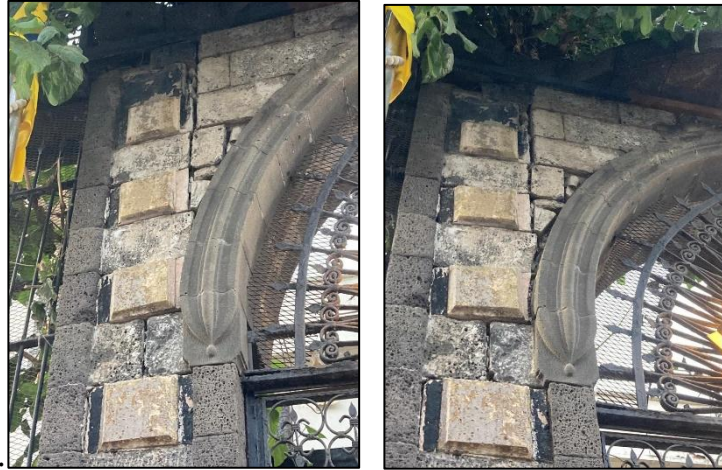
Şekil 13. Avlu giriş kapısının taş yüzeylerinde meydana gelen parça kopmaları ve derz boşalmaları (2023)
