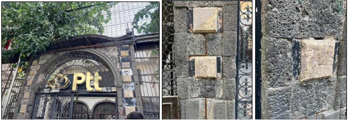
Şekil 10. Avlu Giriş Kapısının Taş Yüzeylerinde Meydana Gelen Çatlaklar (2023)
