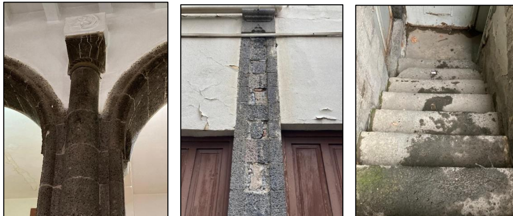
Şekil 1. İç ve dış mekân sütunlarında ve merdiven yüzeyinde meydana gelen aşınmalar (2023)
