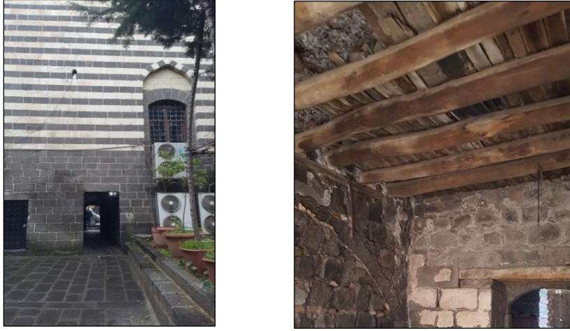
Şekil 3: Melik Ahmet Paşa Cami “kabaltı”sı ile Sait Paşa Sokak’taki “kabaltı”daki yüzeysel hasarlar (Budak,2023)
